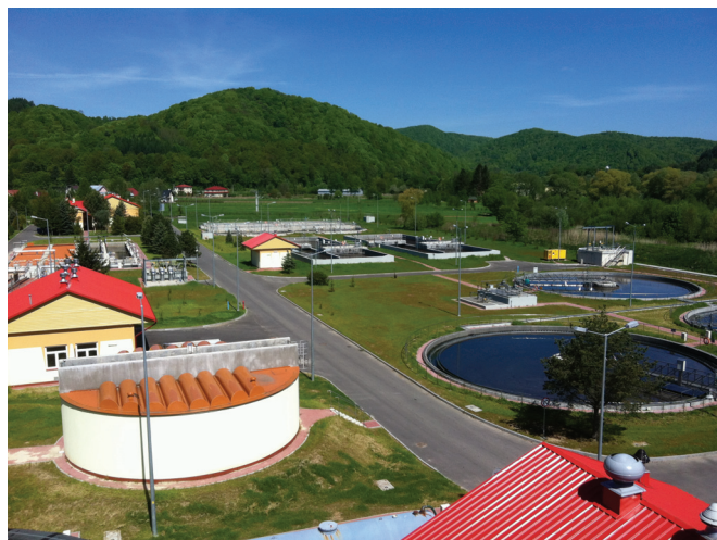
Rys. 2.1.4. Urządzenia mechaniczno-biologicznej oczyszczalni ścieków w Treczy (pow. sanocki) zmodernizowanej w 2013 r. (źródło: [25])
