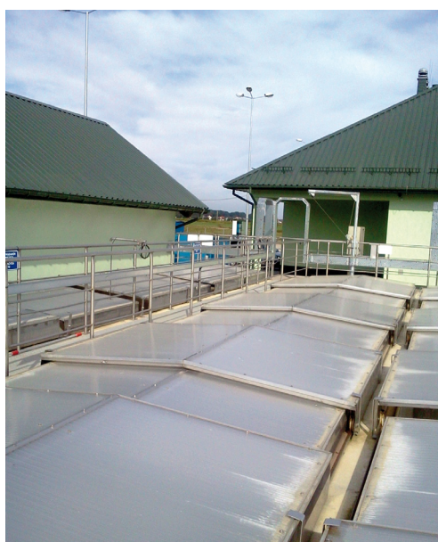
Rys. 2.1.5. Urządzenia mechaniczno-biologicznej oczyszczalni ścieków w Jaworz Górnym (pow. dębicki) oddanej do eksploatacji w 2013 r. (źródło: [25])
