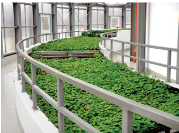
Rys. 2.2.11. Przepływowa laguna hydroponiczna – trzeci stopień oczyszczania ścieków na oczyszczalni ścieków komunalnych m. Skołyszyn, 2009 r. [28]
