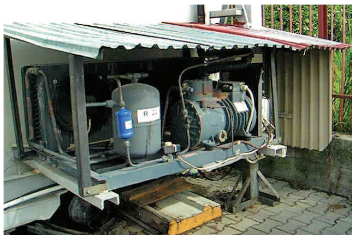
Rys. 7.3.2. Instalacja chłodnicza z wykorzystaniem R-22 (SZWO) w Zakładzie Przetwórstwa Mięsnego „Szarek”, Jarosław – Widna Góra, 2012 r. [28]
