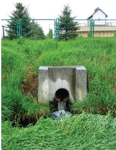
Rys. 2.2.9. Wylot kolektora ścieków z oczyszczalni ścieków w Jastkowicach, (gm. Pysznicza) do rowu odprowadzającego ścieki do rzeki Bukowa, 2012 r. [28]
