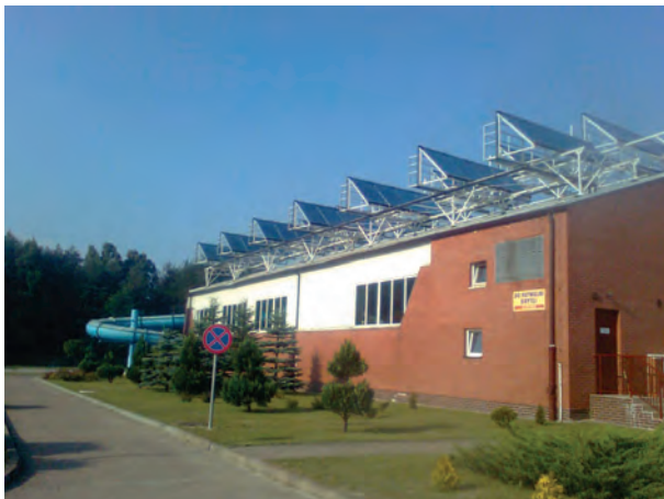
Rys. 10.2. Instalacja solarna na budynku krytej pływalni w Cmolasie, pow. kolbuszowski (źródło: [41])
