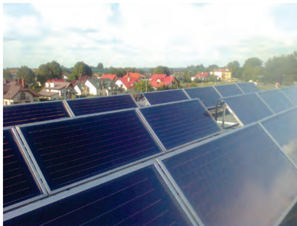
Rys. 10.5. Instalacja do produkcji energii ze słońca na hotelu „Blue Diamond” w Nowej Wsi, pow. rzeszowski (źródło: [41])
