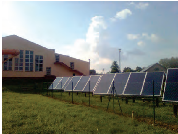
Rys. 10.3. Instalacja solarna przy krytej pływalni w Głogowie Małopolskim, pow. rzeszowski (źródło: [41])
