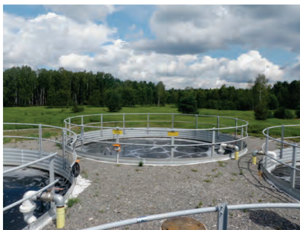
Rys. 4.1.11. Urządzenia mechaniczno-biologicznej oczyszczalni ścieków w Radomyślu nad Sanem (gm. Radomyśl nad Sanem) (źródło: [41])
