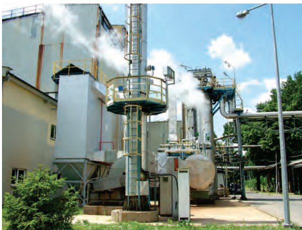
Rys. 8.4.1. Instalacja do termicznego unieszkodliwiania odpadów w „LERG” S.A. w Pustkowie, pow. dębicki, 2012 r. (źródło: [41])
