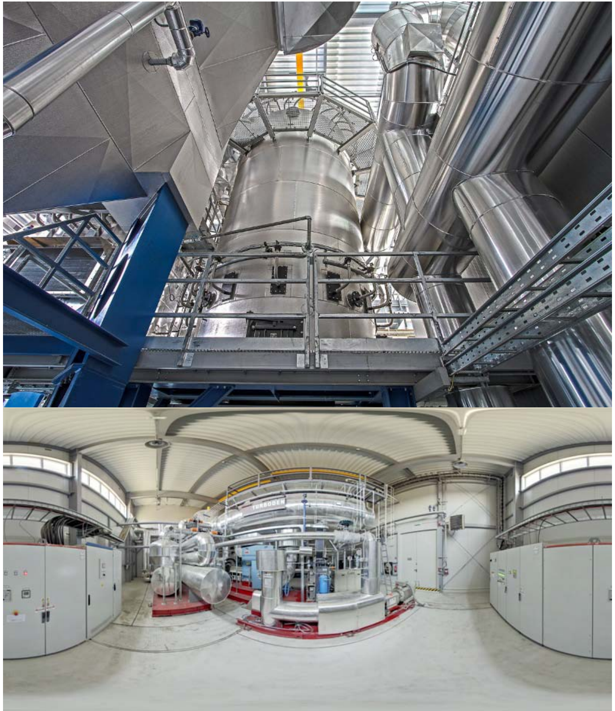
„Blok kogeneracyjny ciepła (6,8 MWt) i energii elektrycznej (1,225 MWe) opalany biomasą w Ciepłowni Łężańska w Krośnie” Wartość projektu: 40 096 696,10 PLN
